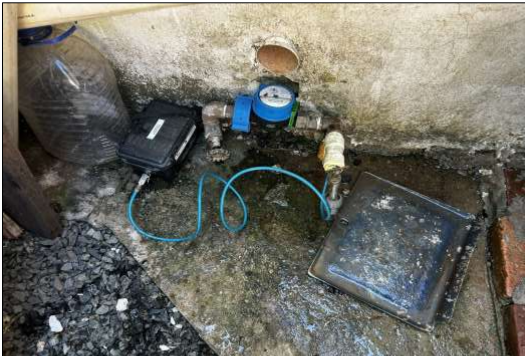
Figura 2. Datalogger de pressão instalado e monitorando dados.
